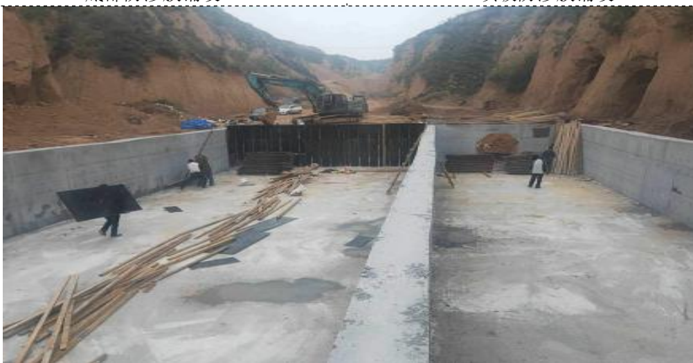
渗滤液调节池
